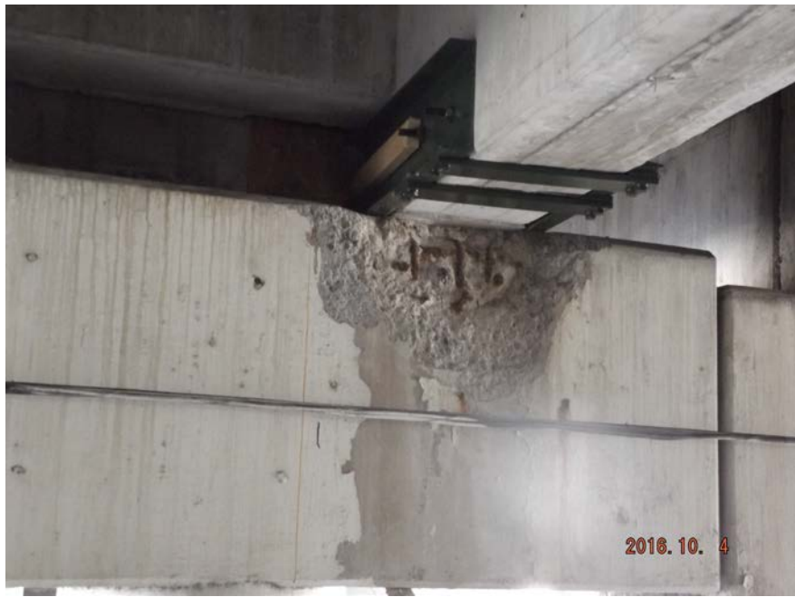
BENT 1 - SPALL - REBAR
